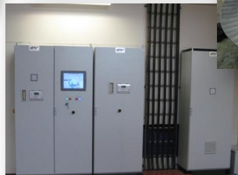
Ny kontrollutrustning till G1 och G2 samt fjärrstyrning och magnetisering
